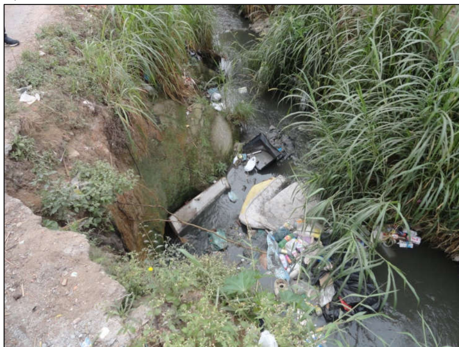
Foto FC-ITA-06-01.02: Observar a quantidade de entulho dentro do canal.
