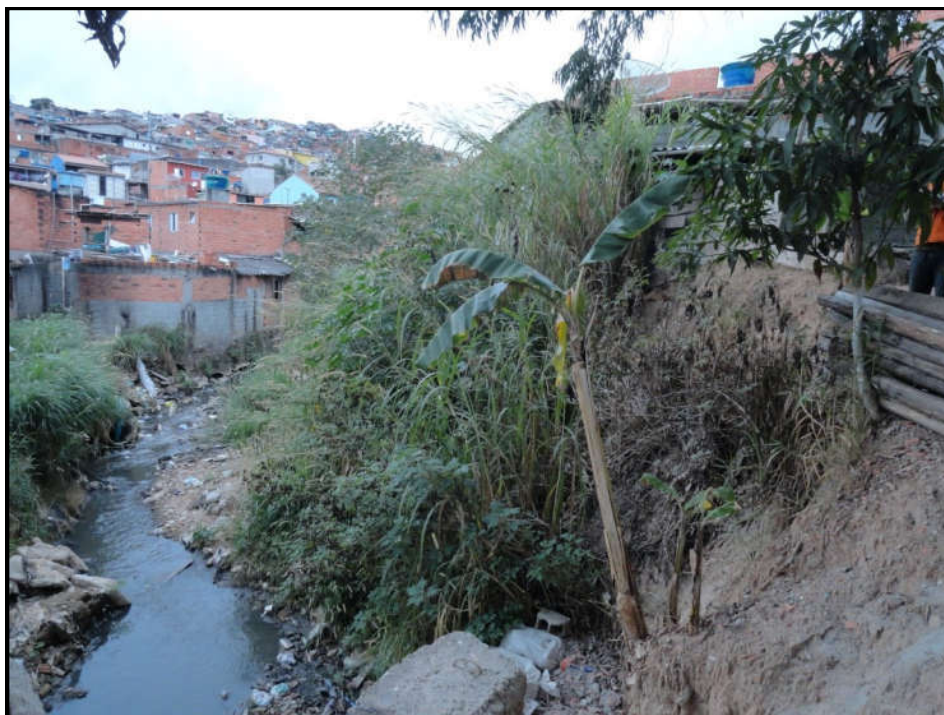
Foto FC-ITA-06-02.01: Vista geral do setor do rio afetado pelo solapamento.
