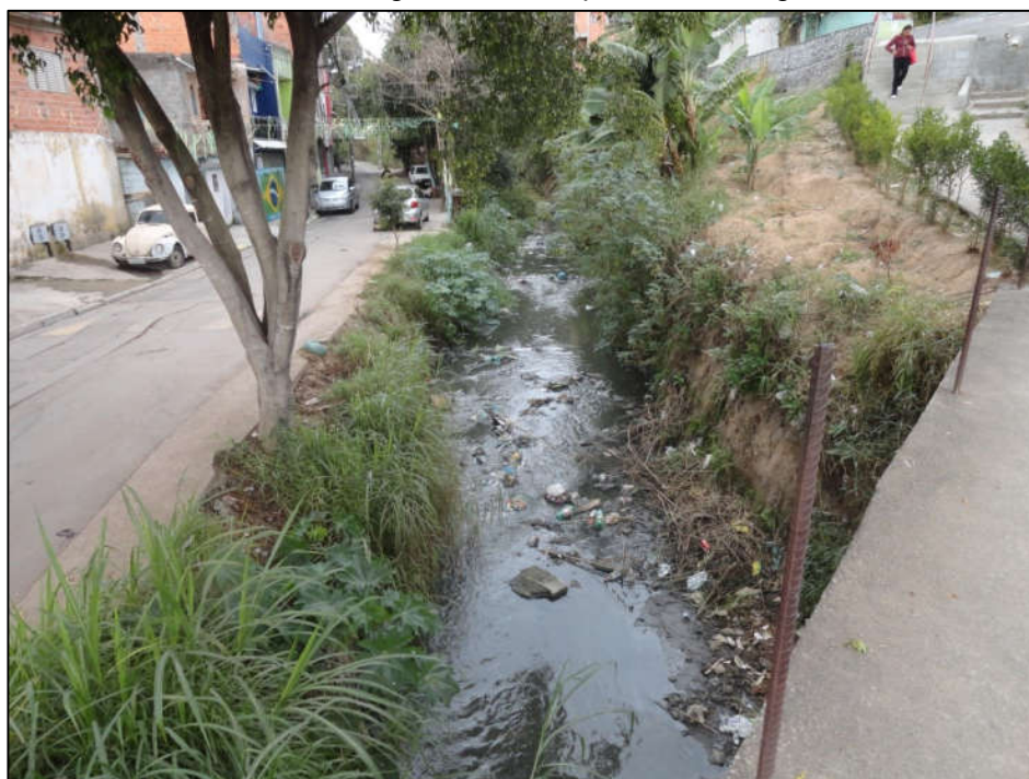
Foto FC-ITA-06-03.04: Vista do córrego a partir da ponte existente. Notar a presença de lixo e solo dentro do canal.
