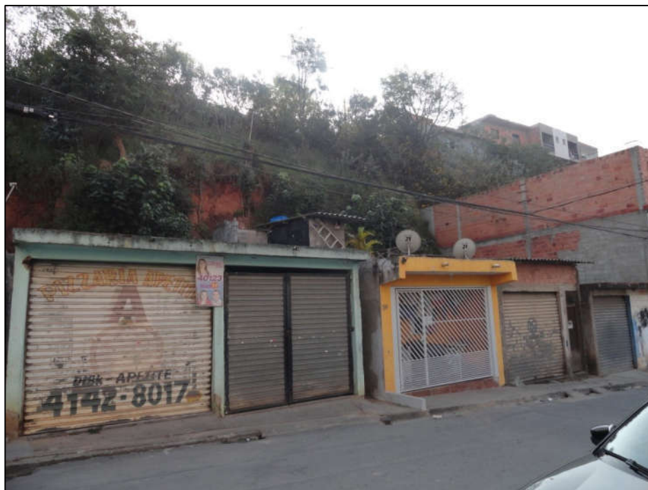
Foto FC-ITA-05-02.01: Vista das moradias em frente à Rua Japi. Notar ao fundo cicatriz de escorregamento no talude de corte.
