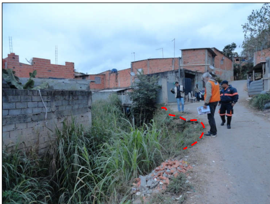
Foto FC-ITA-06-01.04: Detalhe do avanço do solapamento (linha tracejada).
