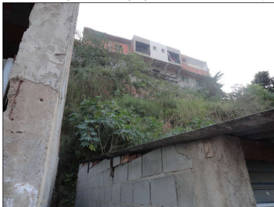
Foto FC-ITA-05-03.02: Vista do lado esquerdo do talude movimentado tendo à frente uma das garagens.
