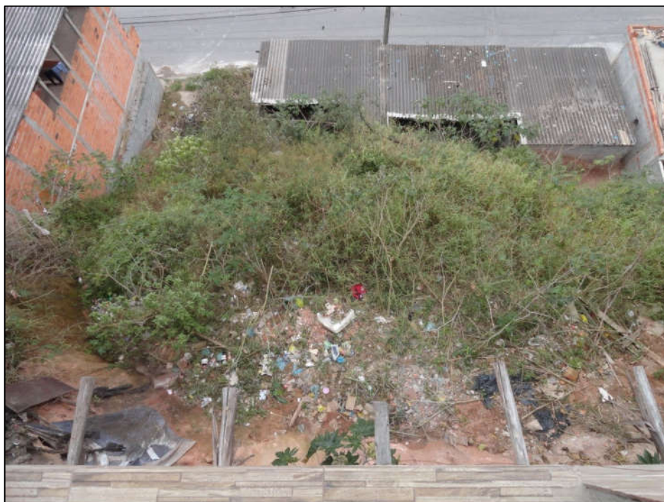
Foto FC-ITA-05-03.06: Vista a partir das moradias em direção à Rua Japi. Notar as 06 garagens na base do talude e a massa de solo que escorregou.
