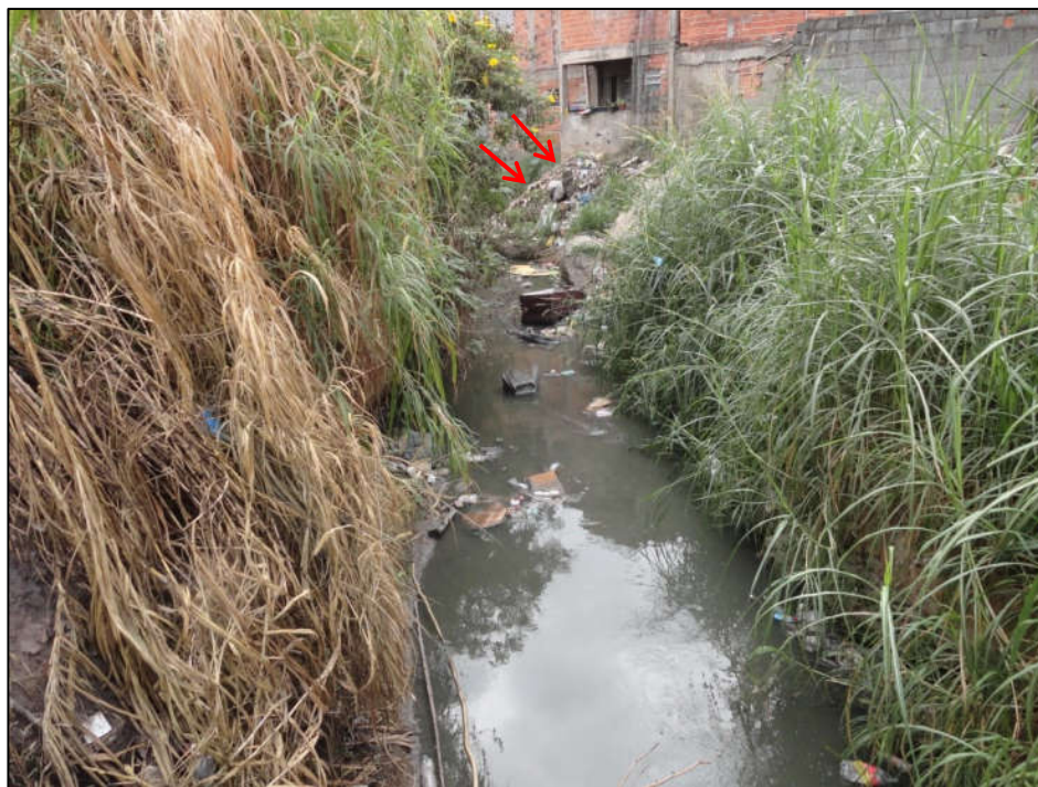
Foto FC-ITA-06-01.03: Detalhe do canal de drenagem. Notar o aterro de entulho e lixo existente (seta vermelha).
