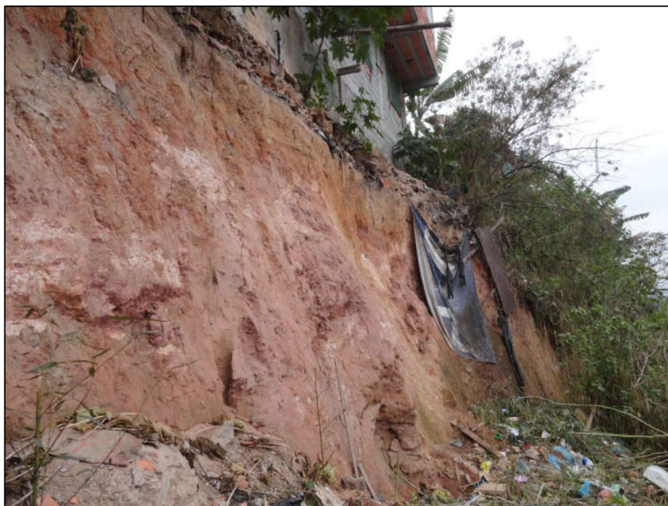
Foto FC-ITA-05-03.04: Talude vertical da cicatriz de escorregamento logo abaixo das fundações das 03 moradias. Notar lixo e entulho sobre a massa escorregada.
